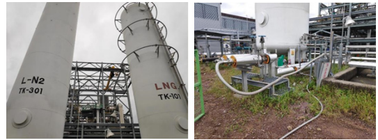
Fig. 4. Supplying LNG from tank
